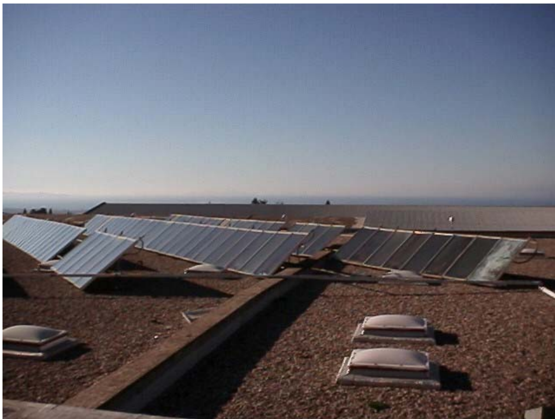
Εικόνα 5 – Ηλιακοί συλλέκτες συνολικής επιφάνειας 308 τ.μ στην οροφή του εμφιαλωτηρίου της ACHAIA CLAUSS A.E. Θερμαίνουν 80 m 3 νερού ημερησίως στους 50 °C.
