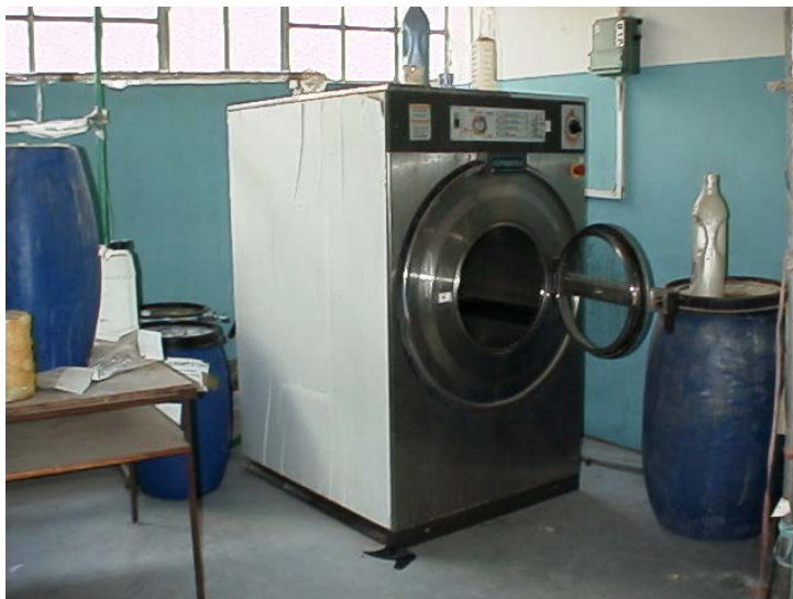
Εικόνα 2: Πλυντήριο ρούχων στη βιομηχανία μεταποίησης παιδικών ρούχων ALLEGRO A.E. (γίνεται χρήση ζεστού νερού 40–90 °C)
