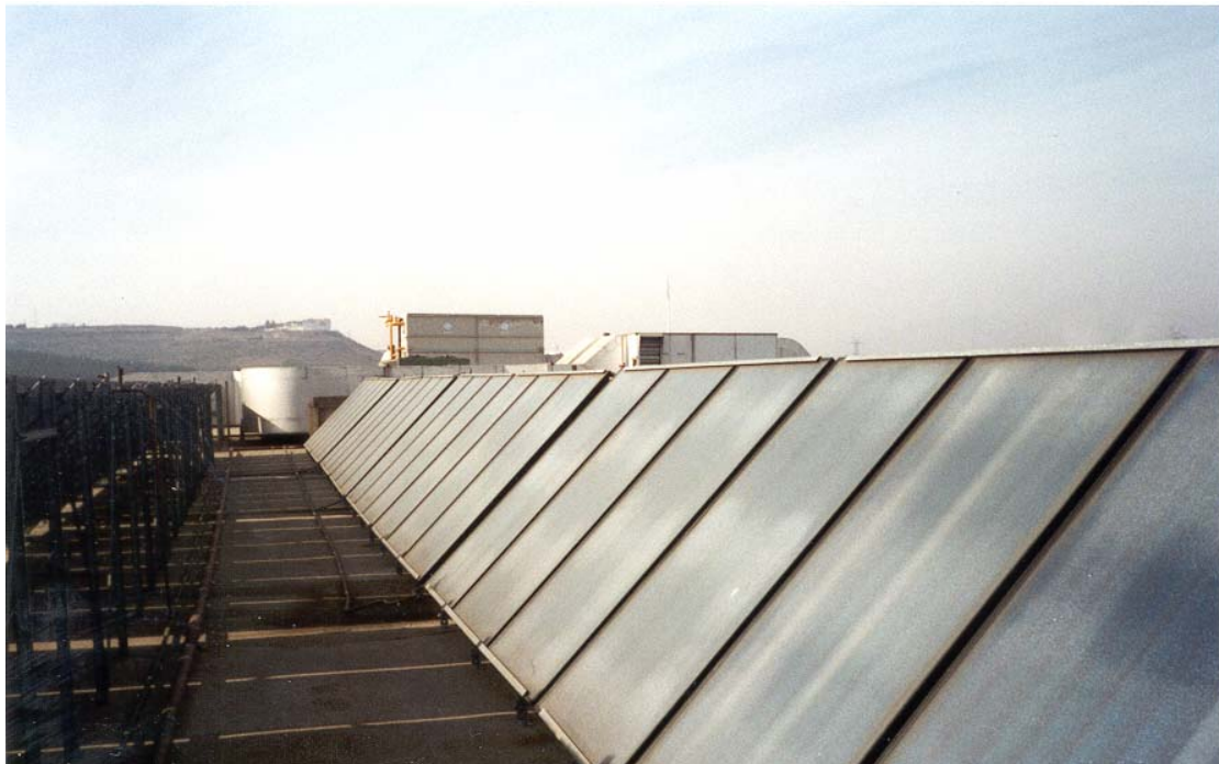
Εικόνα 3 – Επίπεδοι επιλεκτικοί συλλέκτες στην οροφή του τυροκομείου της ΜΕΒΓΑΛ Α.Ε
