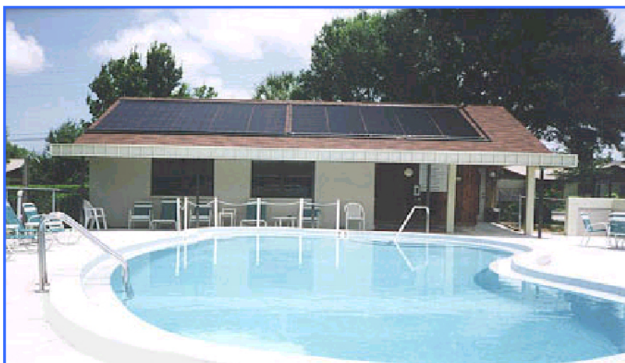
Κατοικία στη Χαλκιδική η οποία χρησιμοποιεί ηλιακούς συλλέκτες για την θέρμανση της πισίνας (έργο Bonair)
