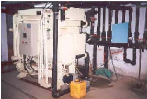
Το έργο ηλιακού κλιματισμού 105 kW στο ξενοδοχείο Rethymnon Village στην Κρήτη. (μελέτη-κατασκευή: Sole S, επίβλεψη: Bonair)
