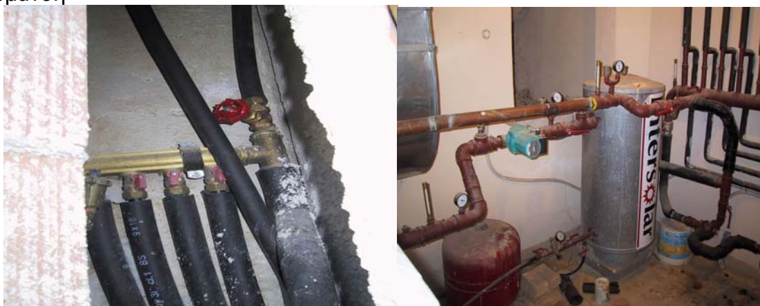
Οι αναχωρήσεις των σωλήνων ζεστού νερού θέρμανσης από το κολλεκτέρ θέρμανσης προς την ενδοδαπέδια θέρμανση καθώς και το μπόιλερ αποθήκευσης της ηλιακής ενέργειας προς την ενδοδαπέδια (έργο Bonair)
