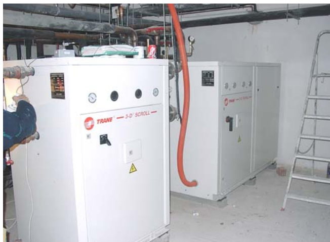
Εικ. 1.α Άποψη των δύο γεωθερμικών Α/Θ νερού-νερού.
