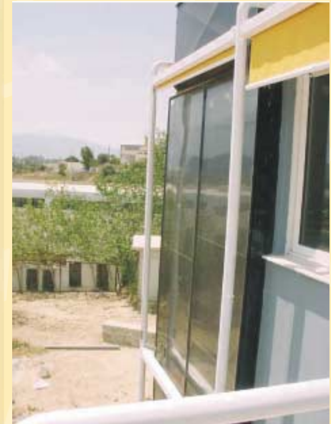
Οι ηλιακοί συλλέκτες στην νότια πρόσοψη του κτιρίου γραφείων του ΚΑΠΕ στο Πικέρμι, Αττικής
