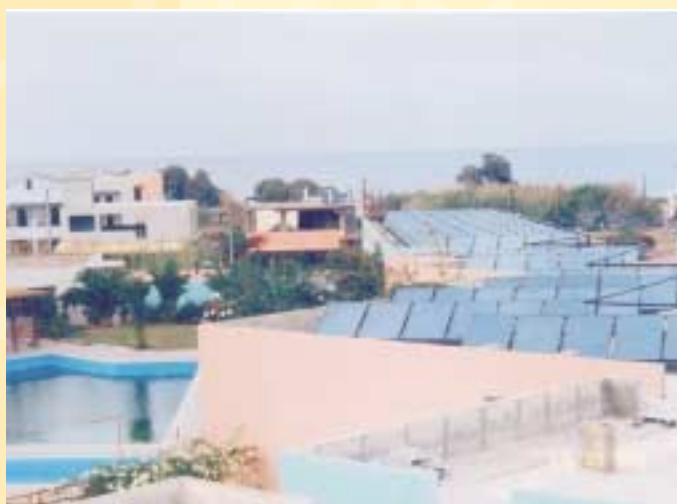
Οι ηλιακοί συλλέκτες (450 τ.μ) στην οροφή του ξενοδοχείου "Rethymno Village" στην Κρήτη
