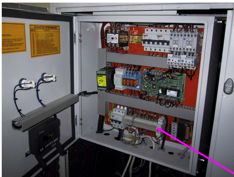
Photo 7: Τοπικός πίνακας της αντλίας θερμότητας. Διακόπτης S/W εντός.
