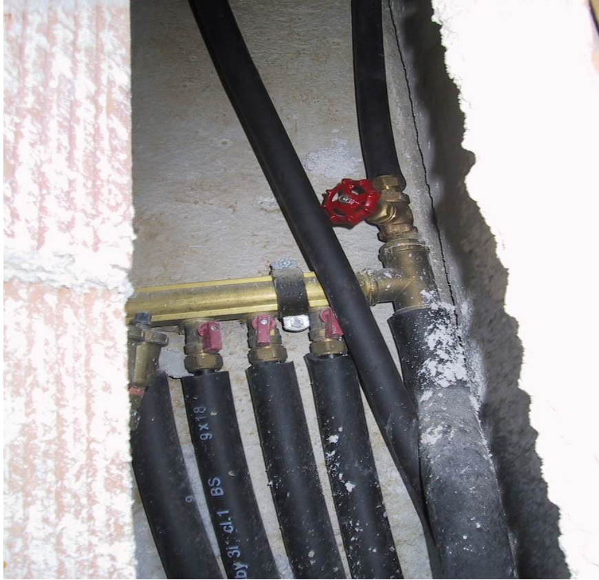
Photo 5: Το διαμέρισμα «ΟΡΟΦ δεξιά» έχει σοφίτα που θερμαίνεται από fan coil (όχι ενδοδαπέδια). Η βάννα της φωτογραφίας βρίσκεται στην μπροστινή βεράντα του εν λόγω διαμερίσματος και για λόγους εξισορρόπησης δικτύου ρυθμίζεται (δες «πίνακα ρυθμίσεων»). Τύπος βάννας: ατμοφράκτης CIBERIO 1/2"
